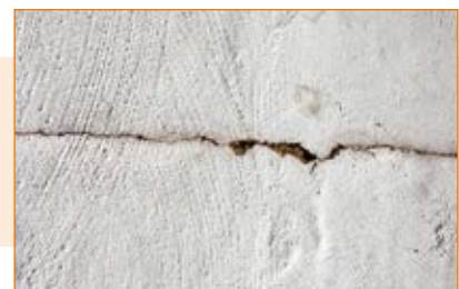
Putzrisse Kategorie C (baudynamische Risse)
