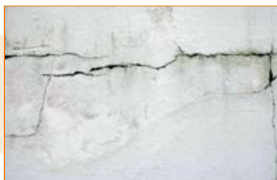
Putzrisse Kategorie B (vom Putzträger ausgehend)
